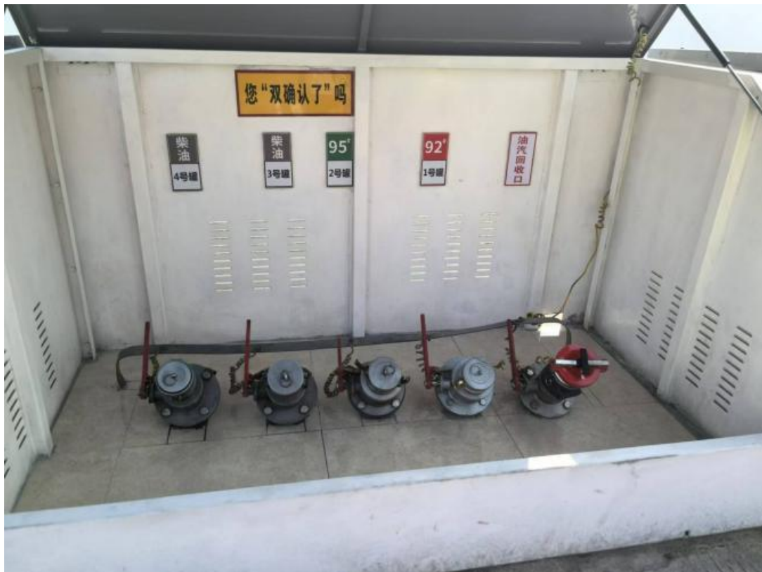
图 4.1-3 油气回收装置
