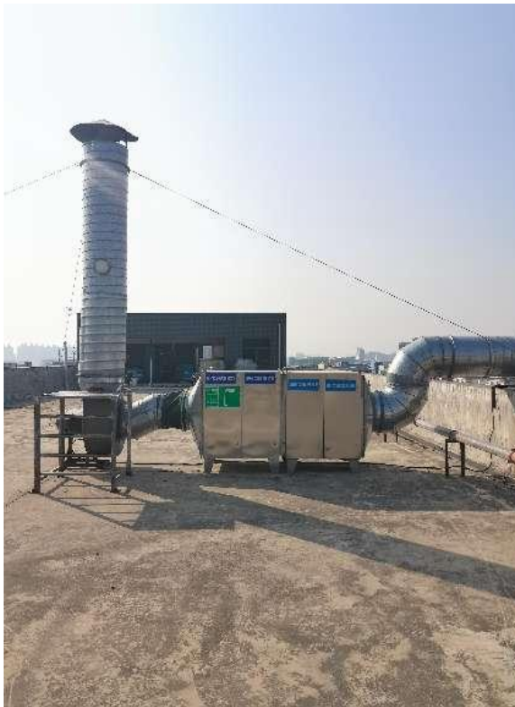
废气排放口（FQ-007673）
