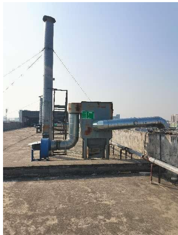
废气排放口（FQ-007674）
