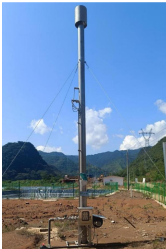
沼气火炬燃烧废气排放口 (DA004)
