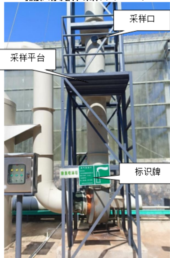
排放口标识牌和采样口 (DA001)
