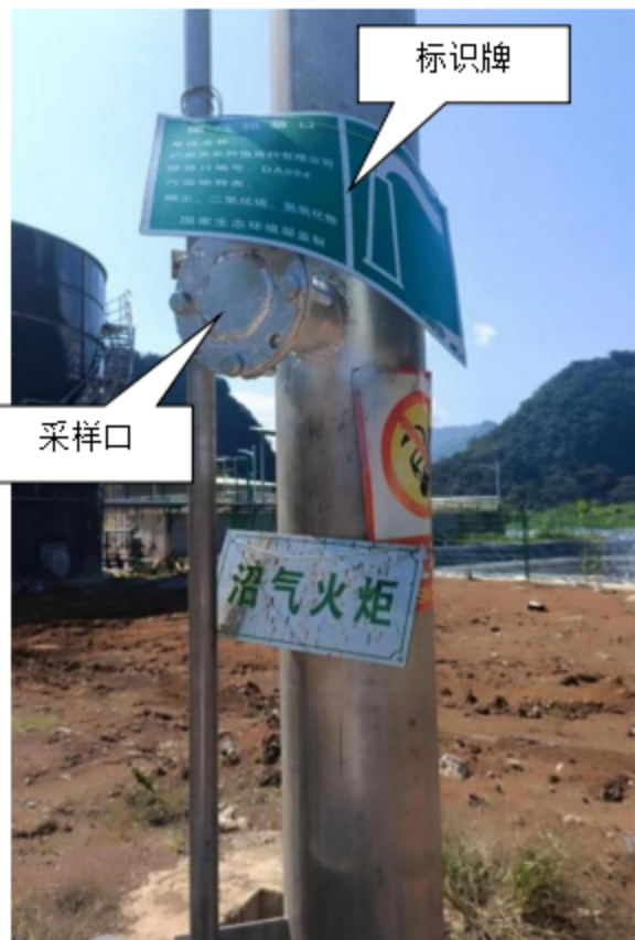
排放口标识牌和采样口 (DA004)
