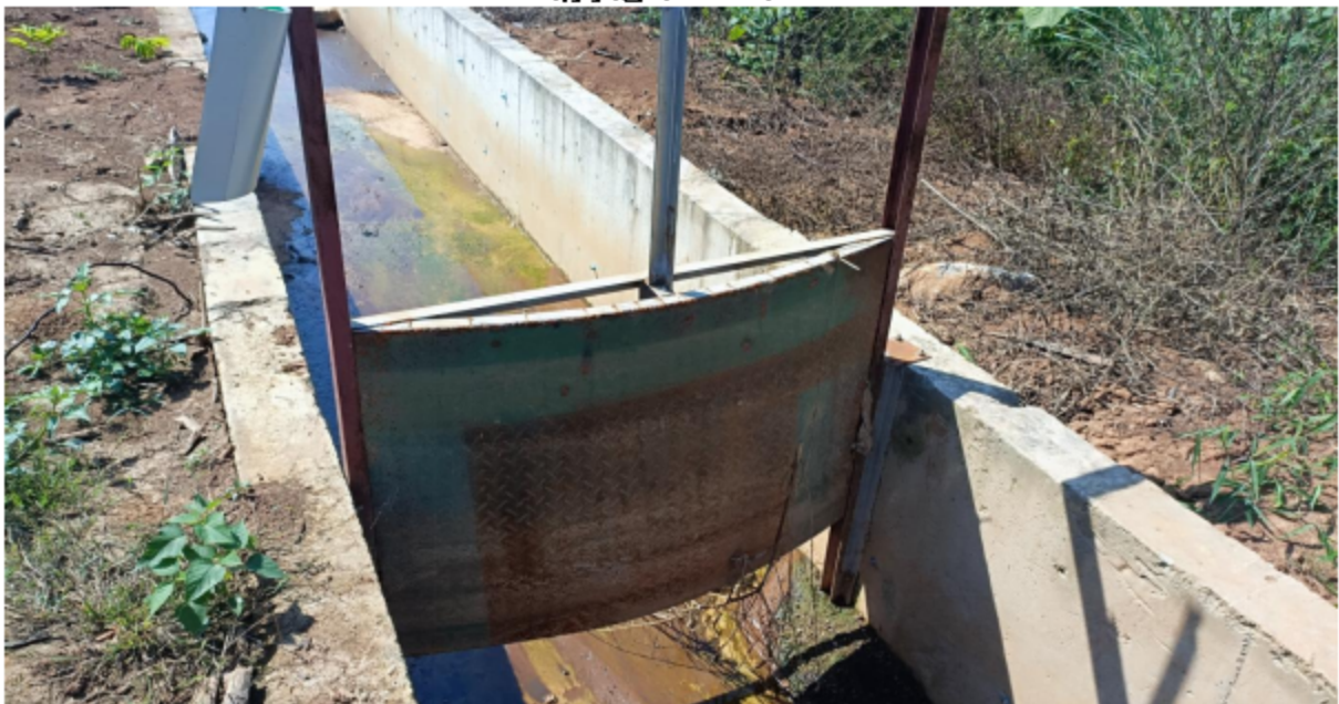
雨水总排放口应急阀门
