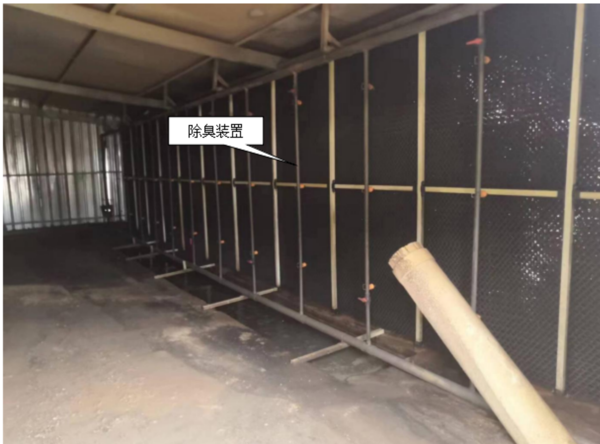
图4.1-6 立式喷淋洗涤过滤除臭装置
