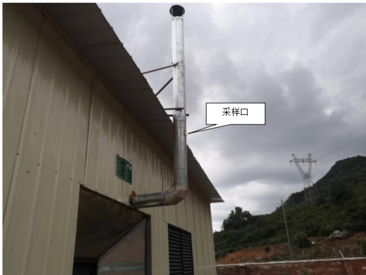
食堂油烟废气排放口（DA005）
