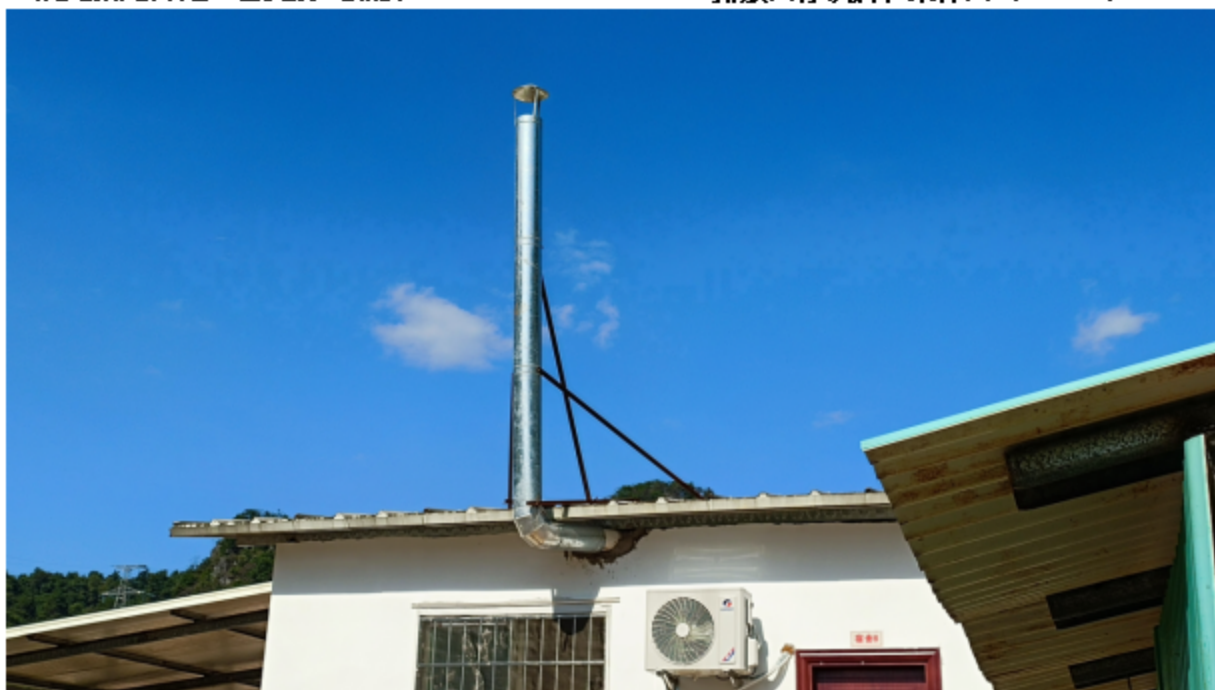
备用发电机废气排放口 (DA003)
