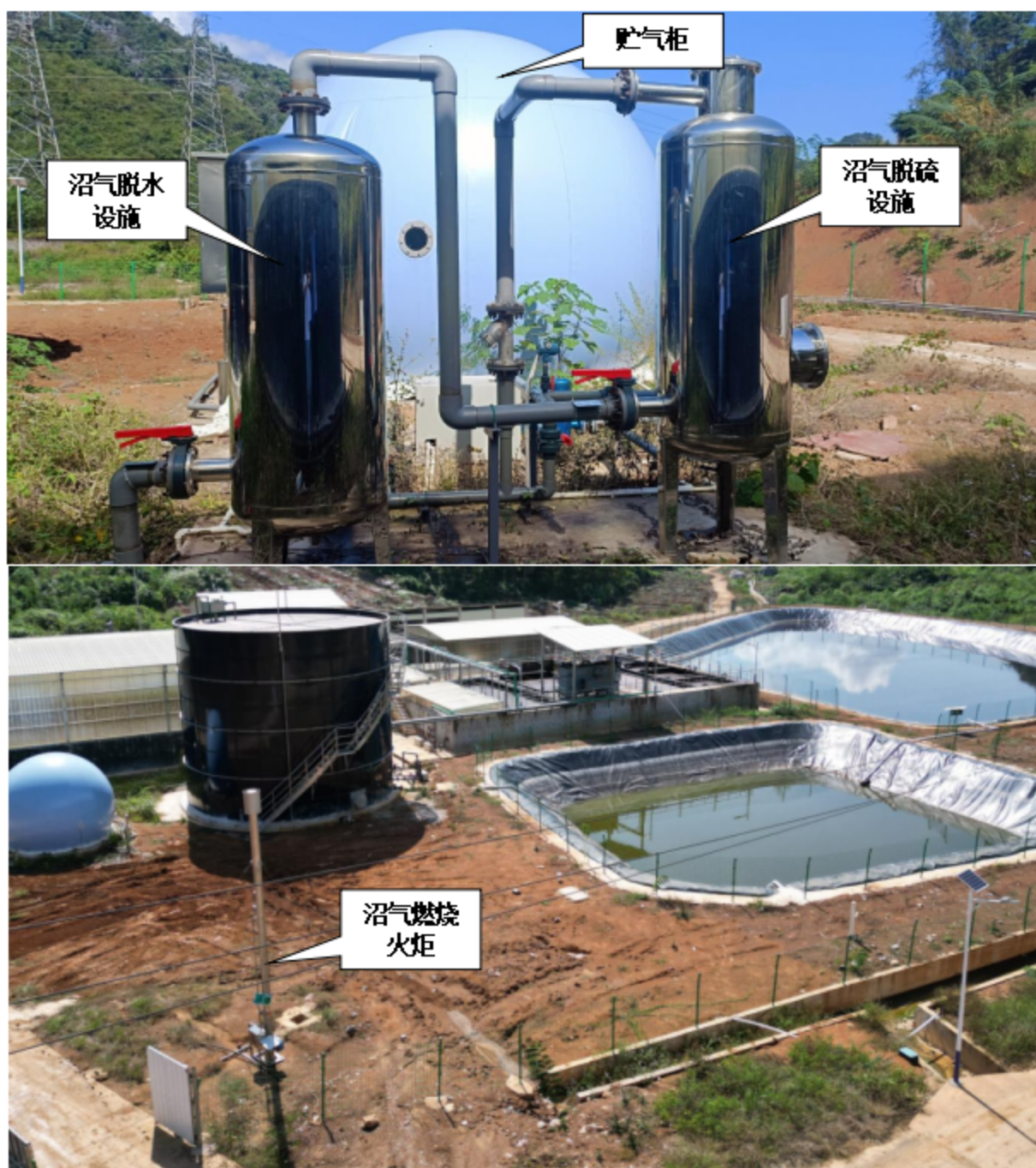
图4.1-10 沼气燃烧废气治理设施
