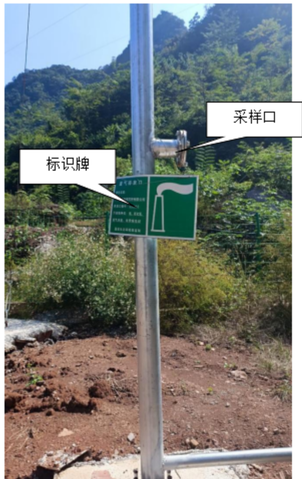
排放口标识牌和采样口 (DA002)
