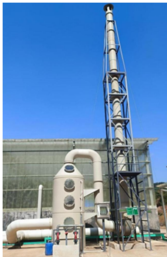
固液分离间和污水处理站废气排放口 (DA001)
