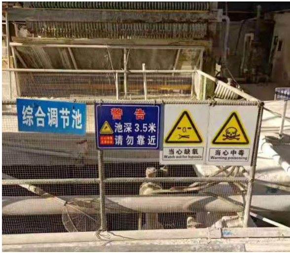
综合废水调节池
