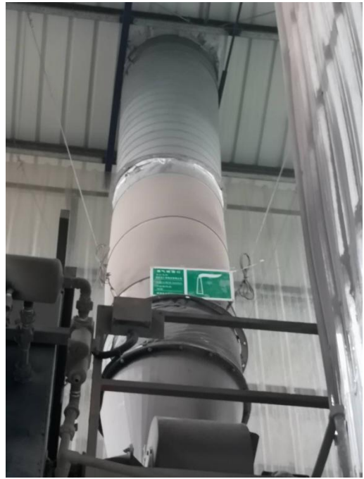
喷涂废气排放口
