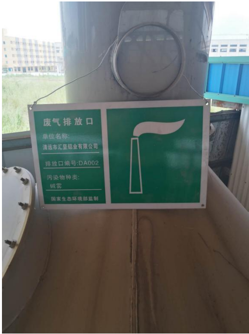
煲模废气排放口
