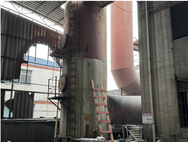
碱液喷淋脱硫塔+静电除尘器
