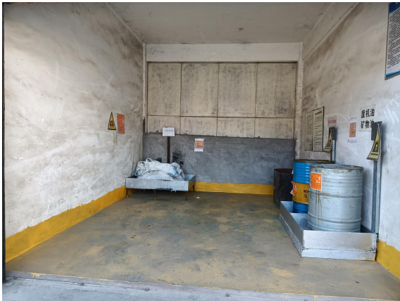
危废仓库 1 (TS001) 内部
