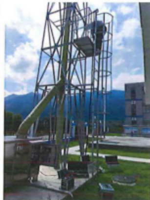
除臭装置排气筒(DA001)
