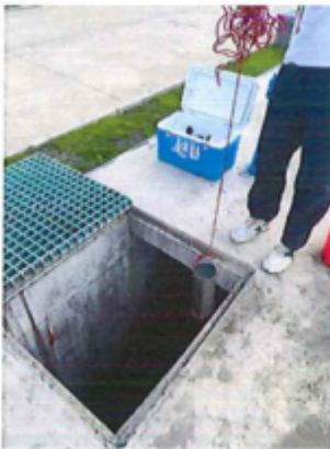
进水总管(MW001)
