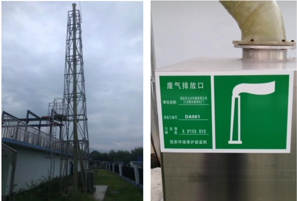
废气排放口（DA001）
