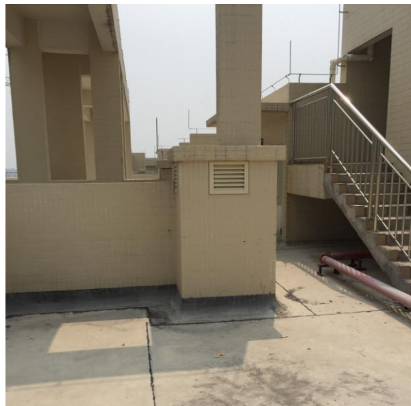
楼顶油烟排放烟囱 1
