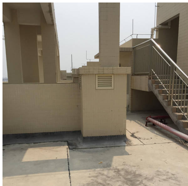
楼顶油烟排放烟囱 1
