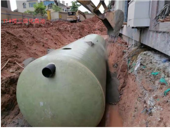
11#楼三级化粪池
