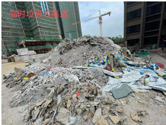
垃圾临时收集点
