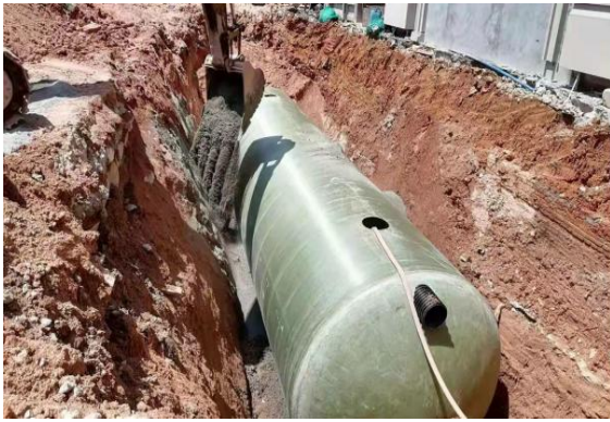
9#楼三级化粪池
