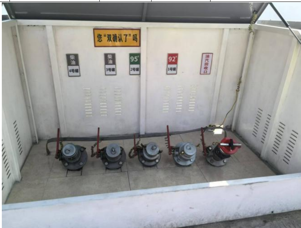
图 4.1-3 油气回收装置
