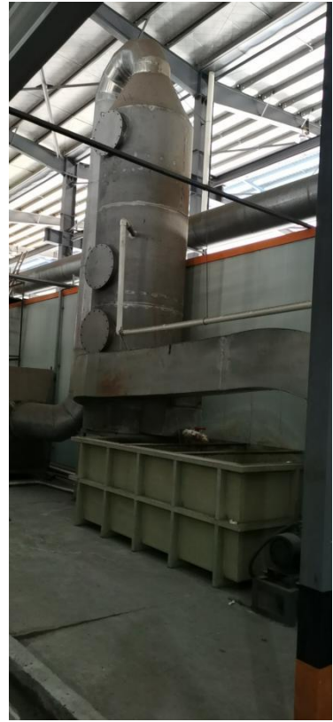
喷淋塔（喷涂废气）
