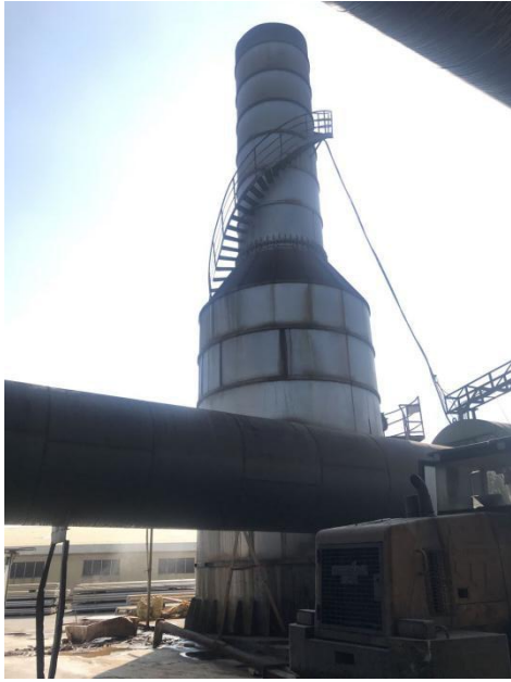
喷淋塔（熔炉废气）
