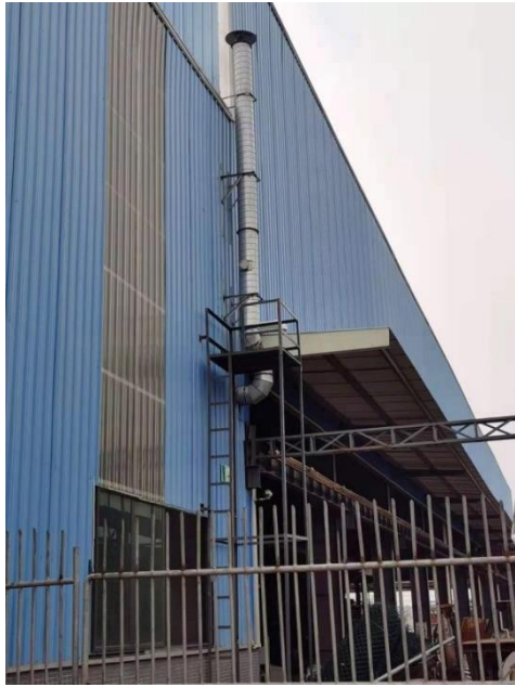
挤压废气排放口
