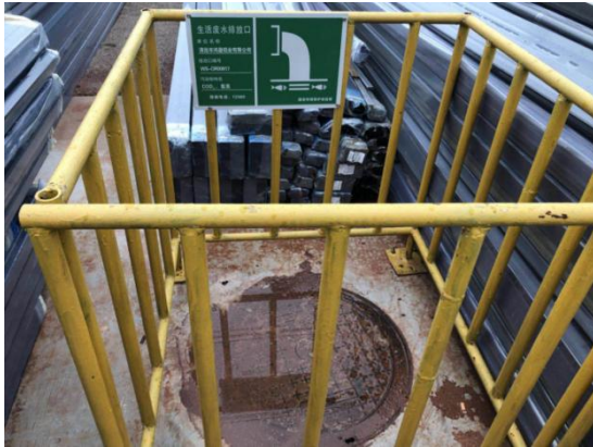
生活污水排放口
