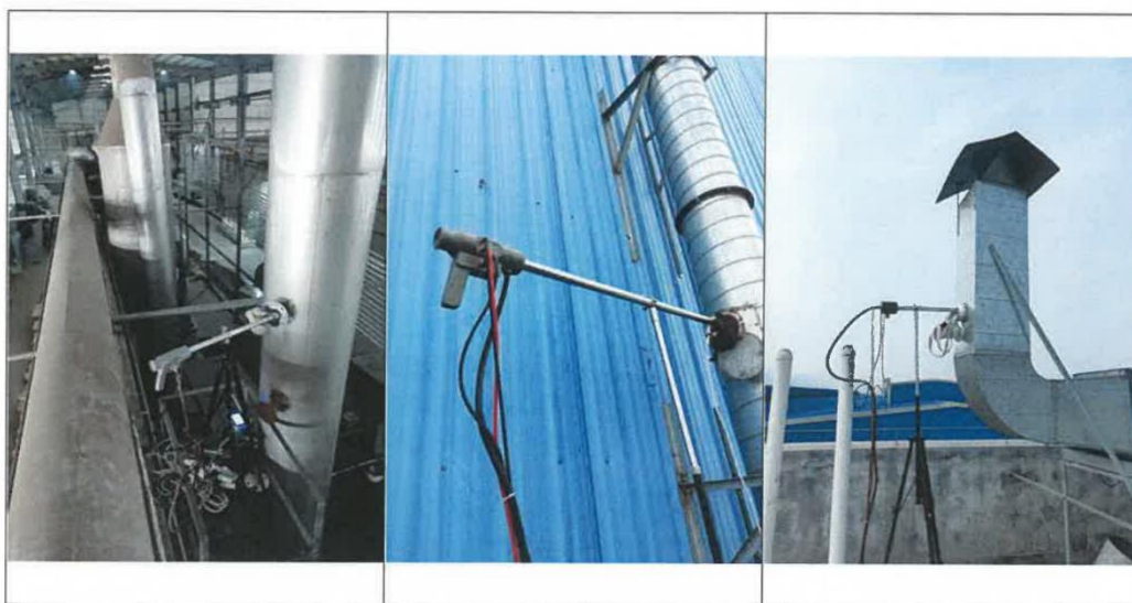
喷涂废气 FQ-OR0745-3 排放口处理后
