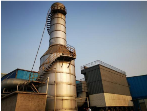
熔铸废气排放口
