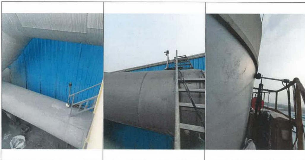
熔炼废气 FQ-OR0745-1 排放口处理前 1
