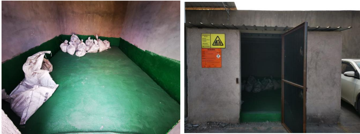
图 4.1-9 项目一期工程危废仓库照片
