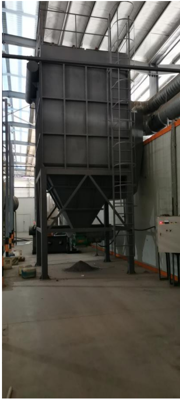
布袋除尘器（喷涂废气）
