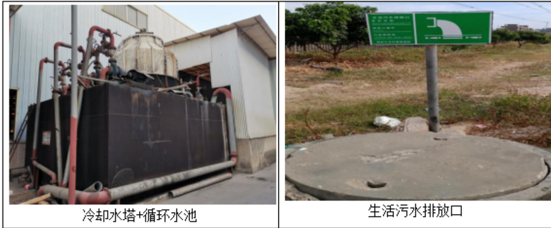
图4.1-1 项目二期工程依托的废水处理设施图
