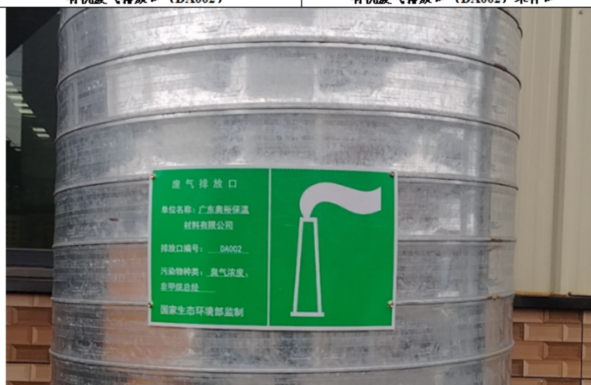
有机废气排放口 (DA002) 标识牌
