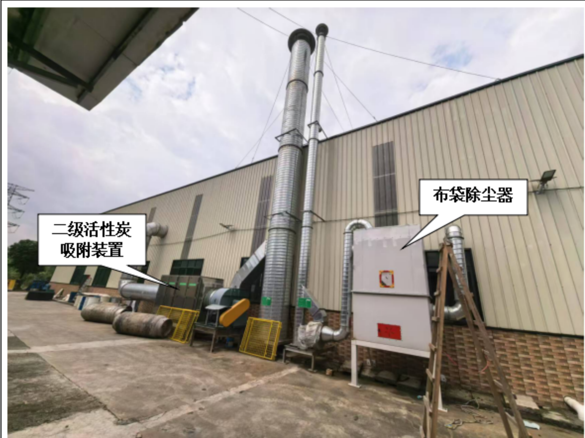
图 3.1-3 废气治理设施图
