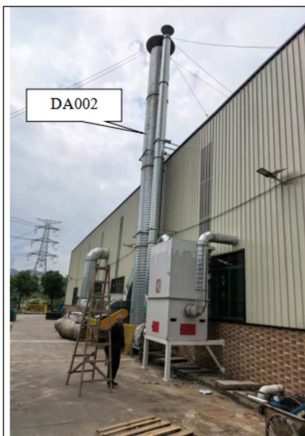
有机废气排放口 (DA002)
