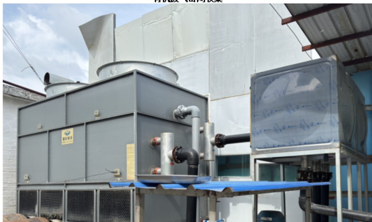
冷却循环水塔
