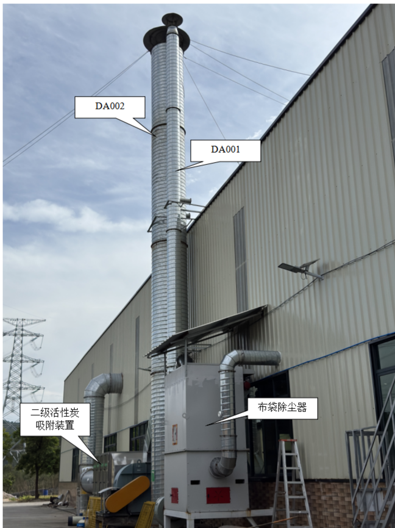
废气治理设施及排放口
