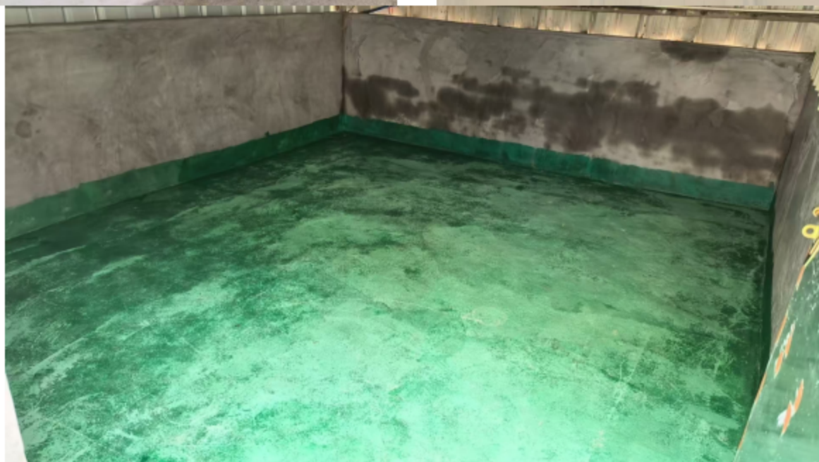
一般固体废物暂存间
