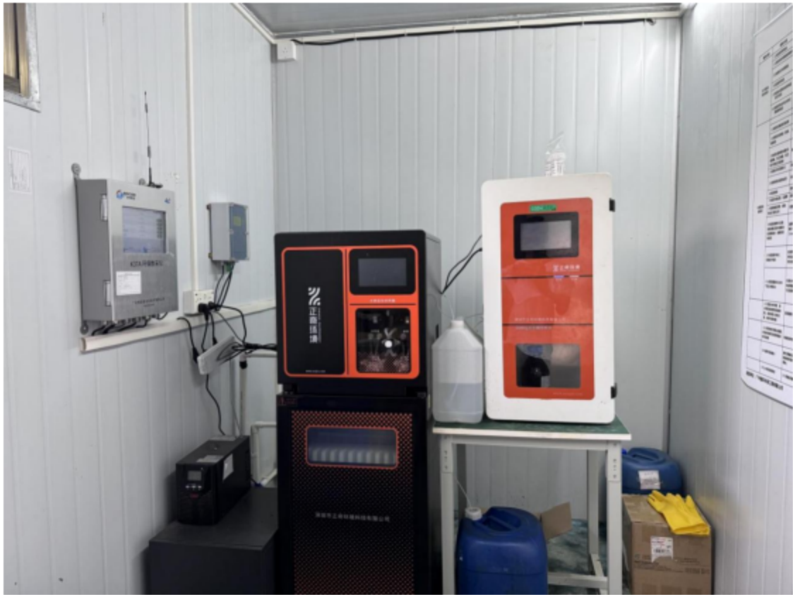
污水在线监测系统
