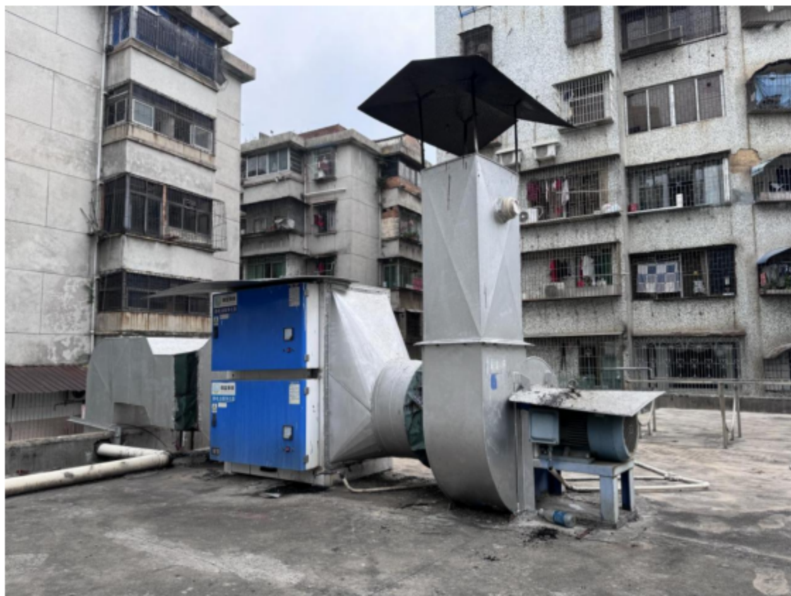
食堂油烟废气排放口
