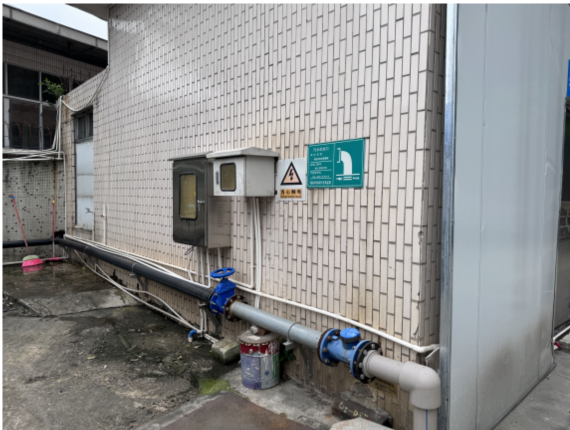
综合废水排放口
