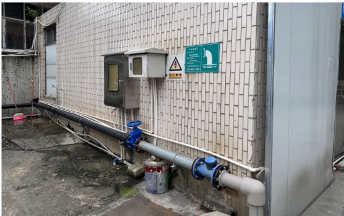
废水排放口 (DW001)
