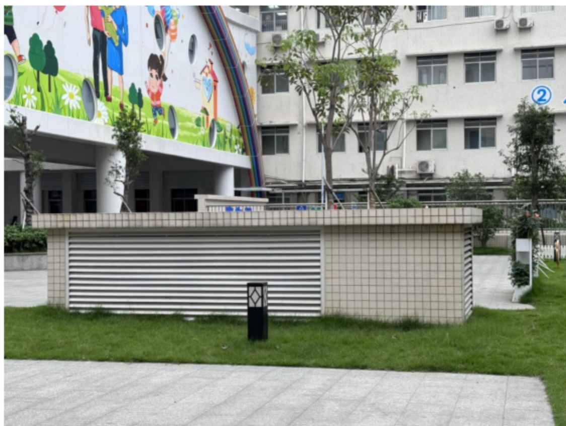
地下车库排风口
