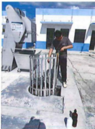
进水总管(MW001)
