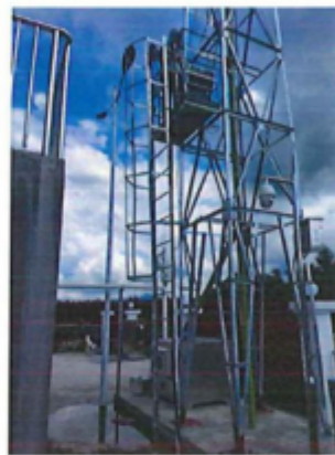
除臭装置排气筒(DA001)
