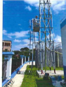
除臭装置排气筒(DA001)
